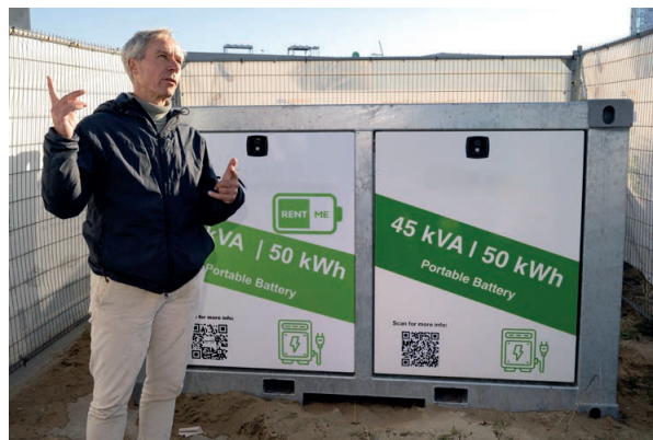
Patrick Segeren (boven) en Bart van Velthoven demonstreren de hardware die het delen van lokaal opgewerkte stroom mogelijk maakt.
